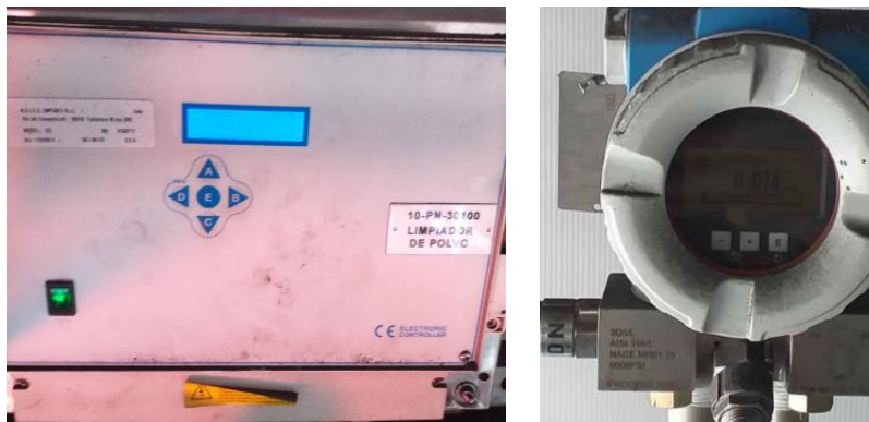
(Fig. 9) PLC del sistema de limpieza típico y (Fig. 10) medidor de presión industrial inteligente
