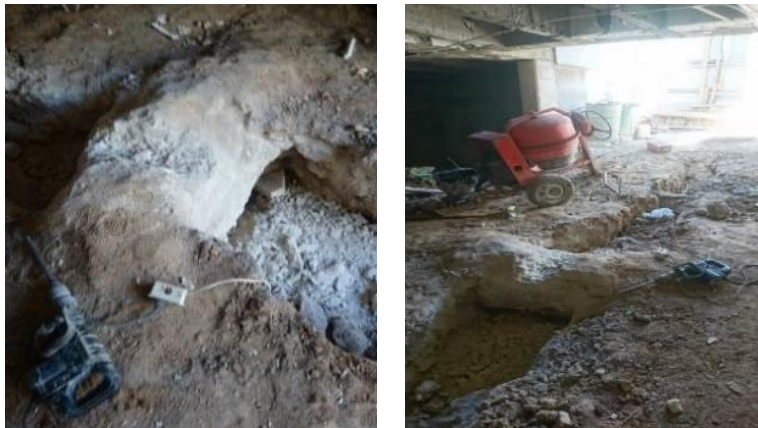
Figura 1. Material rocoso encontrado en el sótano y parqueadero del edificio.
