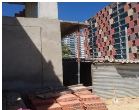
Figura 2. Desplazamiento vertical del voladizo de un balcón.
