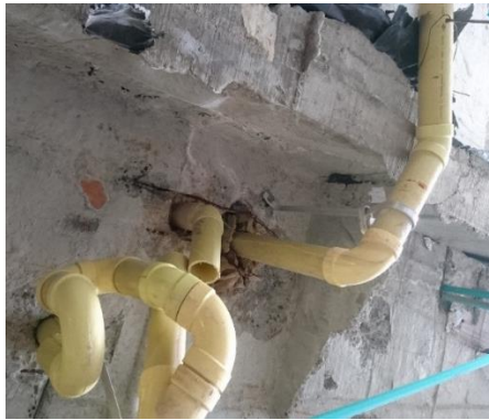
Figura 6. Exposición del refuerzo de la losa.
