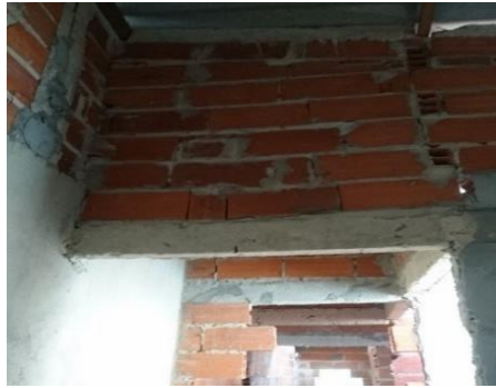
Figura 3. Deflexión en viga dintel.
