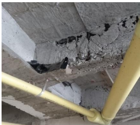
Figura 5. Acero de refuerzo expuesto.
